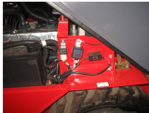
Reläer och huvudsäkring ovanför höger bakhjul
